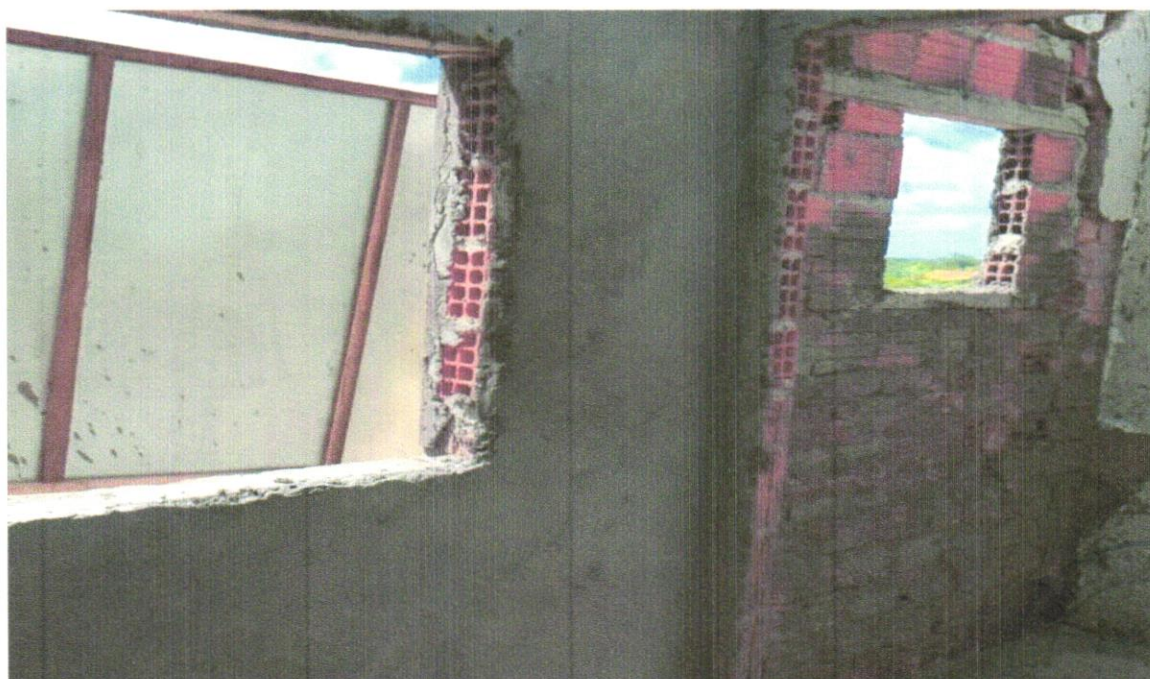
FOTO 10 – CHAPISCO APLICADO EM ALVENARIA (COM PRESENÇA DE VÃOS) E ESTRUTURAS DE CONCRETO DE FACHADA, COM EQUIPAMENTO DE PROJEÇÃO. ARGAMASSA TRAÇO 1:3 COM PREPARO EM BETONEIRA 400 L. AF_06/2014 e MASSA ÚNICA, PARA RECEBIMENTO DE PINTURA OU CERÂMICA, ARGAMASSA INDUSTRIALIZADA, PREPARO MECÂNICO, APLICADO COM EQUIPAMENTO DE MISTURA E PROJEÇÃO DE 1,5 M3/H EM FACES INTERNAS DE PAREDES, ESPESURA DE 5MM, SEM EXECUÇÃO DE TALISCAS. AF_06/2014
